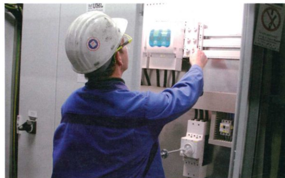
Fünf Schaltschränke tragen dazu bei, dass bei Sachtleben Energie gespart werden kann, gebaut.
